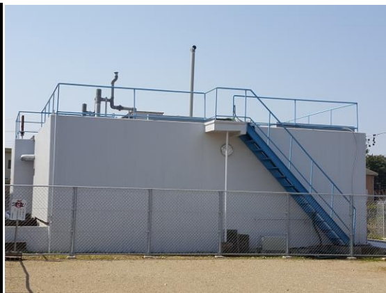
集中浄化槽施設（丹羽井端地区）
