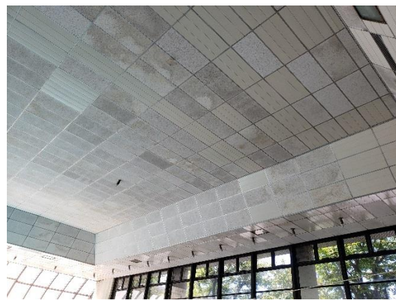
温水プールの天井、修繕の跡
