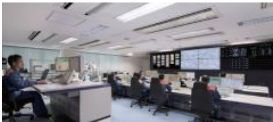
稲沢市と共同運用している高機能消防指令センター
